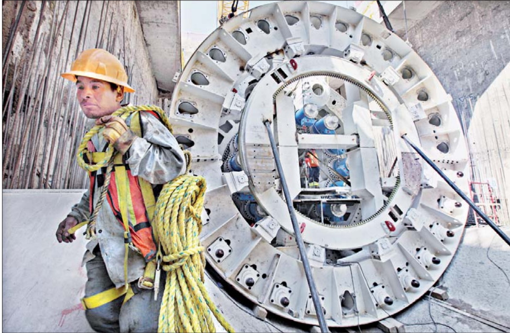
La construcción de la nueva línea del Metro ha significado un reto en materia de ingeniería por las condiciones del subsuelo, que es blando y con alto contenido de humedad. En la imagen, los trabajos de perforación en el tramo que conectará las estaciones Atlalilco y Mixcoac ■ Foto José Carlo González AGUSTÍN SALGADO ■ 27
