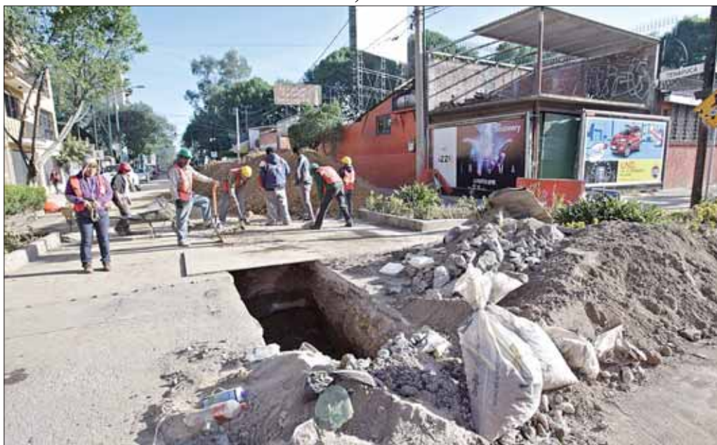
De diciembre a la fecha, en la ciudad de México se han iniciado al mismo tiempo diversas obras, como arreglo de banquetas, habilitación de pasos peatonales, reparación de cableado eléctrico y rehabilitación de colectores de drenaje, que generan severos conflictos viales y obligan a los peatones a caminar entre los coches, debido a que muchas de las autoridades que las ordenan dejan el cargo y el desorden en calles y avenidas ■ Foto Yazmín Ortega Cortés
